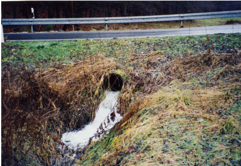
Foto 2: ID 88, Betonrohr mit Absturz unter Straße zwischen Schmiedefeld und Vesser (Aufn.: Verwaltung BR Vessertal)
