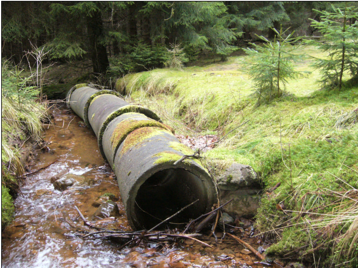
Abbildung 1: Ansicht der alten Betonrohre (Aufn. D. Eckardt, 29.02.2008)
